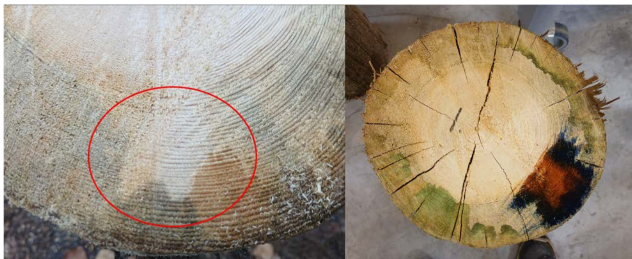
Kuva 4. ANT1-tienvarsipylväs oli pahoin lahonnut. Syynä vajaatunkeuman ja todennäköisesti myös huuhtouman yhteisvaikutus.
