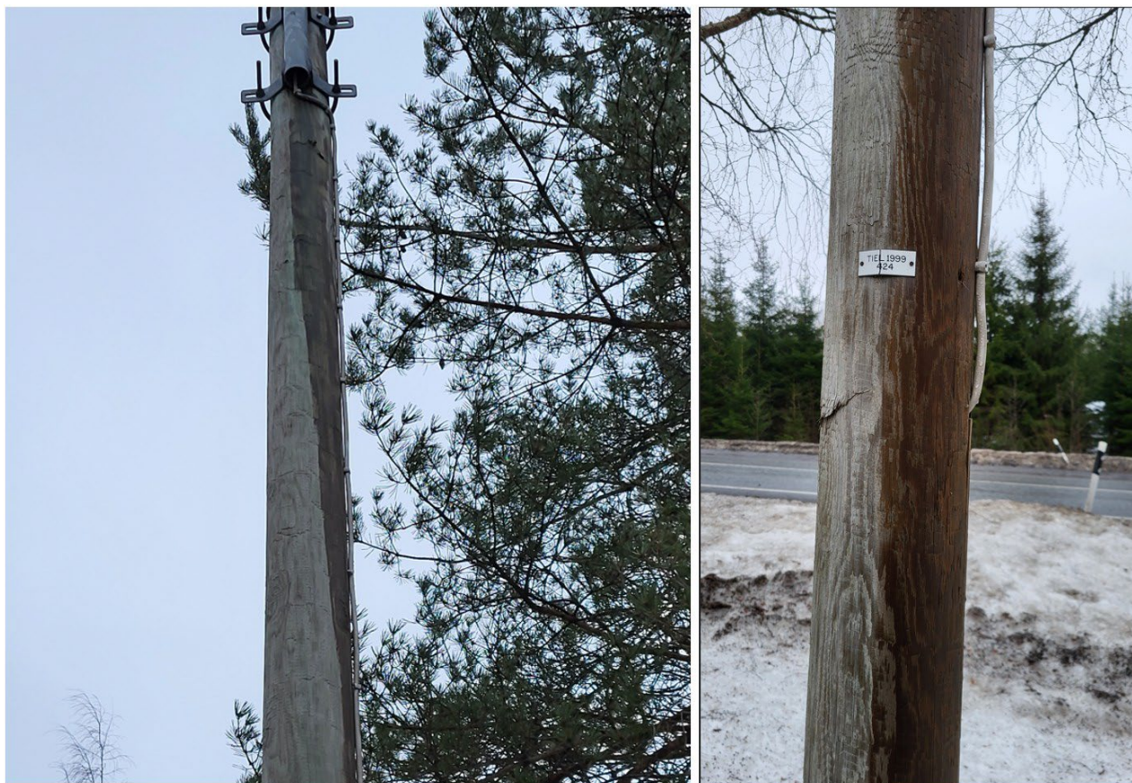
Kuva 12. Pylvään latvasta ja erilaisista ulokkeista pylvään ulkovaippaa pitkin valuva vesi pitää pylvään ulkopinnan kosteana. Kun ulkovaipassa on lisäksi halkeamia, kosteuden on helppo siirtyä pylvään sisäosiin. Kuva: Kai Möller
