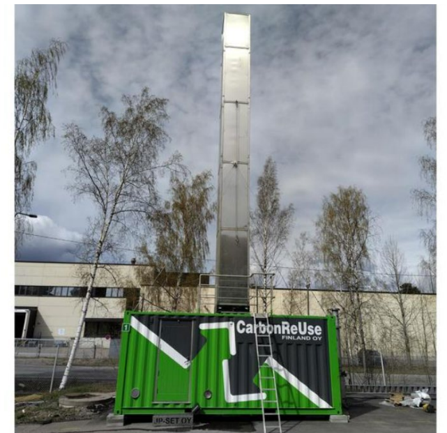
Talteenotokontti. Carbon Reuse Finlandin tekniikka valittiin VTT:n ja Nesteen johtamaan synteettisten polttoaineiden E-Fuel-tutkimushankkeeseen. Kuva toukokuun alusta 2023, muutama viikko ennen demonstraation käynnistämistä. KUVA: CARBON REUSE FINLAND
